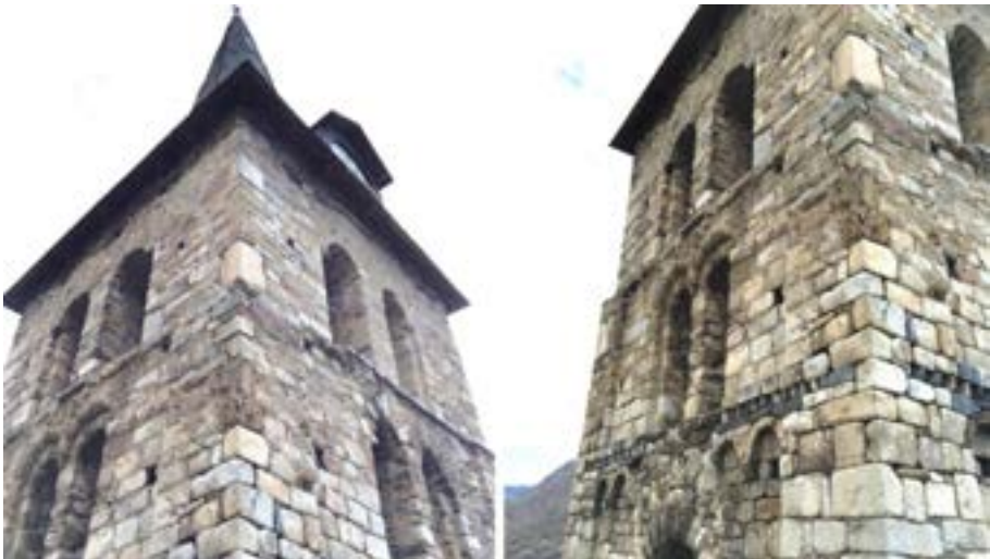
Figura 182. Discontinuitat dera mampostaria d'Era Mair de Diu dera Purificacion de Bossòst [6]
