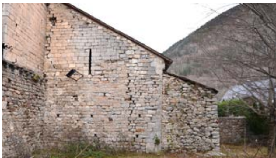
Figura 156. Detalh deth contrahòrt dera façada meridionau, a on s'òbsèrven es desplaçaments dera occidentau de Santa Maria d'Arties [34]
