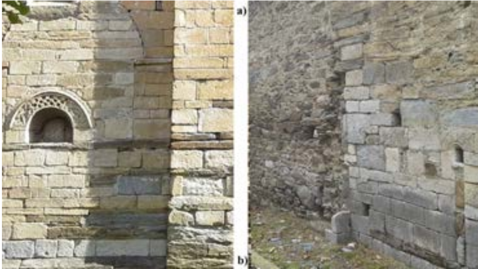
Figura 60. Despeçament e juntes de mortèr en Sant Fèlix de Vilac [24], [40]; a) Façada Sud. b) Façada Nòrd
