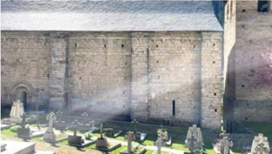
Figura 151. Contrahòrts dera façada septentrionau de Santa Maria de Cap d'Aran de Tredòs [41]
