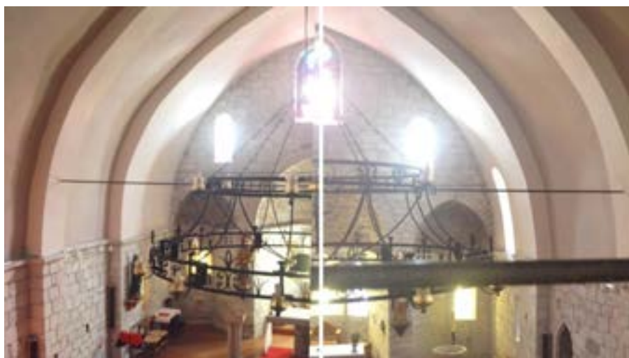
Figura 192. Tensor en dusau tram dera nau de Sant Estèue de Betren [29]
