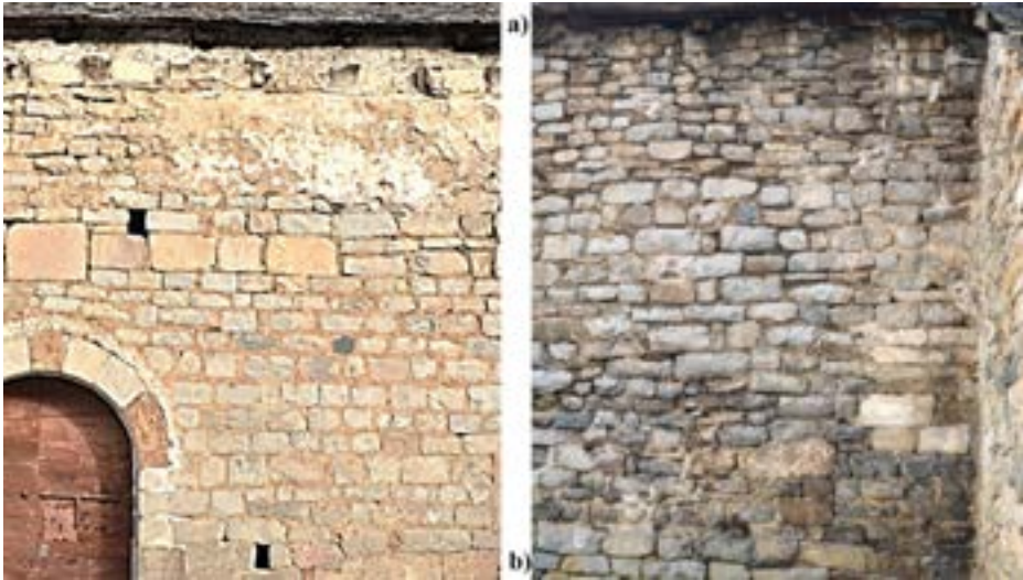
Figura 59. Despeçament de mampostaria e juntes de mortèr en Santa Eulària d'Unha, [40]. a) Façada meridionau. b) Façada septentrionau
