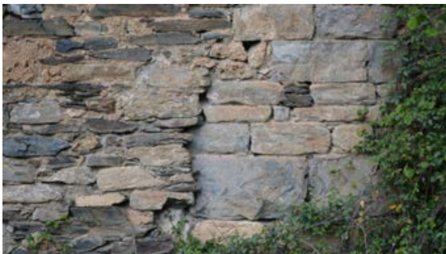
Figura 199. Basa dera façada orientau de Sant Ròc de Begòs [14]
